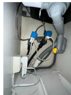
Rørøpplagg i kjøkkenbenk med Waterguard
