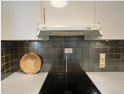
Ventilator monteret i overskap.
