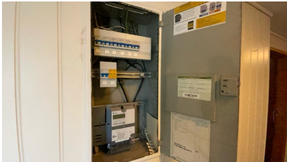
Sikringskåp er i felles gang og har automatsikringer.
