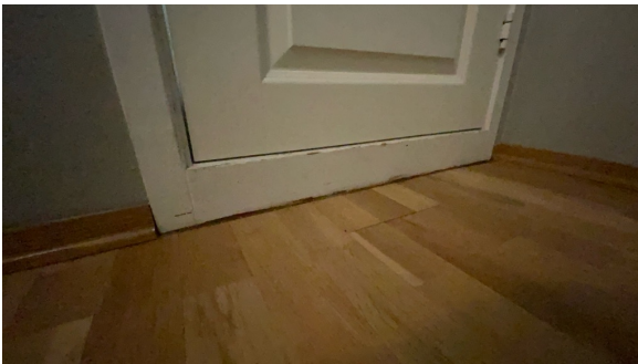
Det er ikke luftespalte i dør til bad
