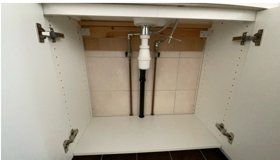
Synlige vannrør er av kobber.
