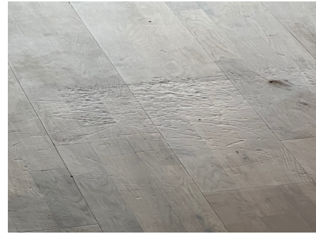
Gulv i stue har merker i overflaten ut over normal slitasje. Bilde fra gulv i stue.
