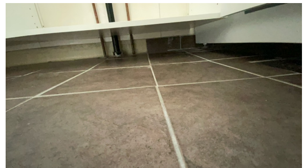
Vannrør kommer opp av gulv under vask på bad, ikke synlig membrankant på vannrør
