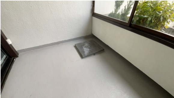
Luke i gulv på balkong for rømming ved brann.
