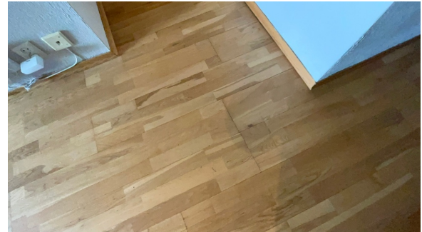
Parkett er ikke lagt fagmessig med skjøt ved siden av hverandre. Bilde fra gulv i stue ved kjøkken.
