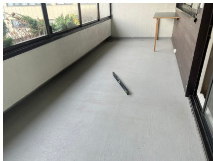
Balkong har mindre fall mot sluk enn anbefalt.
