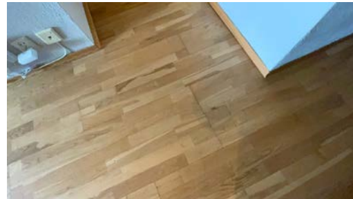
Parkett er ikke lagt fagmessig med skjøt ved siden av hverandre. Bilde fra gulv i stue ved kjøkken.
