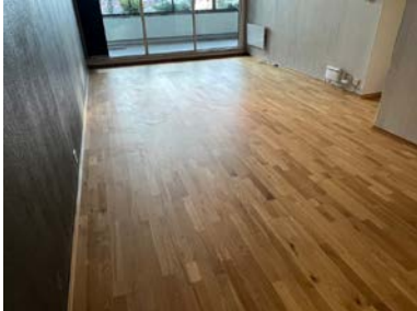
Gulv i stue har merker i overflaten ut over normal slitasje. Bilde fra gulv i stue
