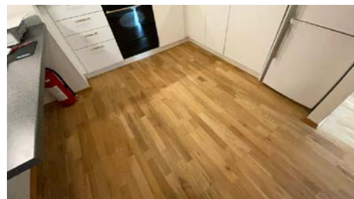
Det ble målt etter skjevheter i gulv på kjøkken.
