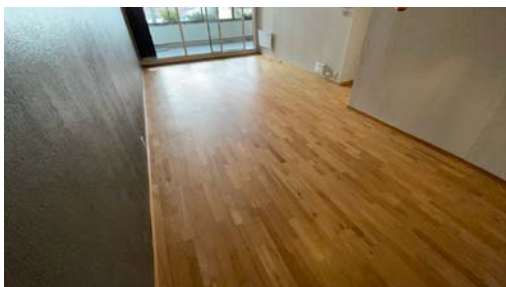
Det ble målt etter skjevheter i gulv i stue.
