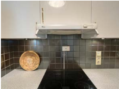
Ventilator montert i overskap.
