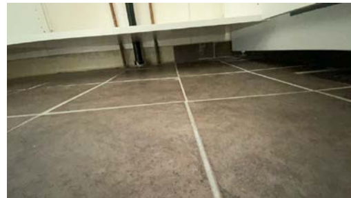
Vannrør kommer opp av gulv under vask på bad, ikke synlig membrankant på vannrør
