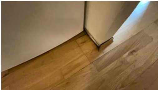
Parkett har fuktskade, her bilde fra kjøkken.
