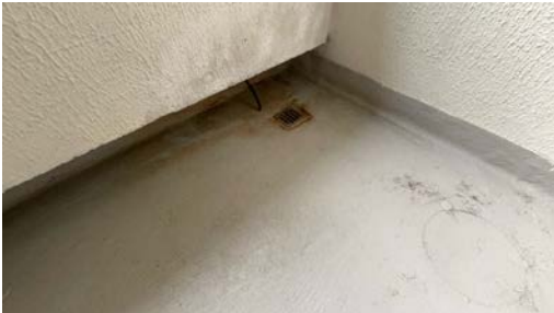
Balkong har sluk i hjørnet.
