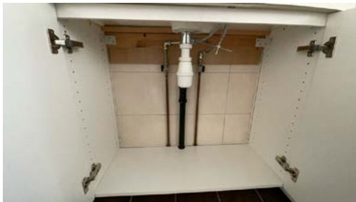
Synlige vannrør er av kobber.
