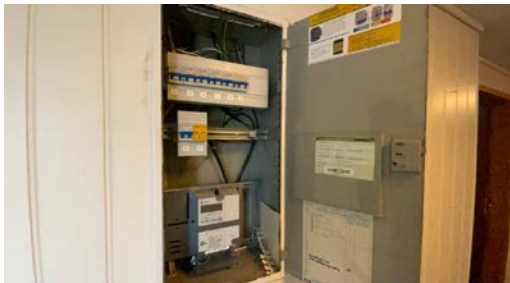
Sikringskap er i felles gang og har automatsikringer.
