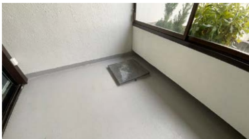
Luke i gulv på balkong for rømning ved brann.
