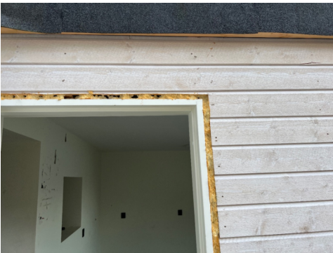
Det mangler lister til ytterdør tilbygg.
