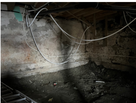
Delvis utgravd kjeller. Fuktighet i kjeller.
