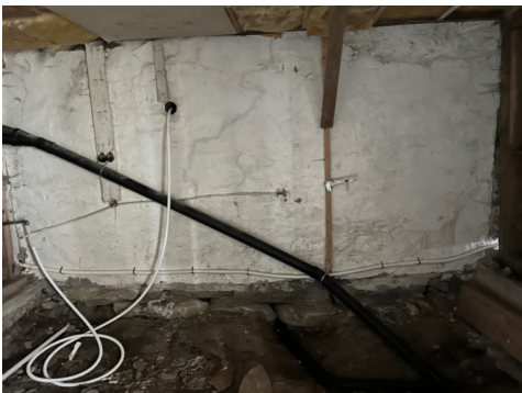
Fuktighet i kjeller.
