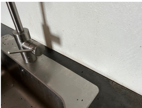
Mangler fuger mot vegg.
