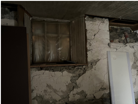
Sprekker i grunnmur.
