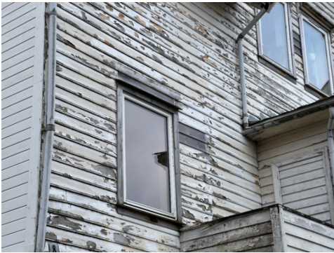
Dårlig kledning med råteskade på vest og nord vegg.
