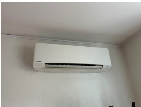
Varmepumpe i stue 1. etasje leilighet vest.
