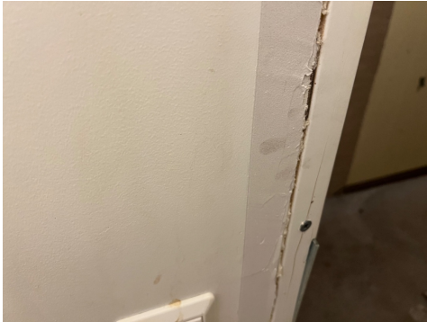
Skade på ytterdør til leilighet.
