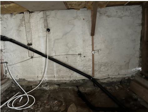
Sprekker i grunnmur.
