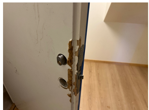
Skade på dør til leilighet.
