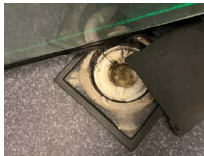
Plastsluk i dusjsone.
