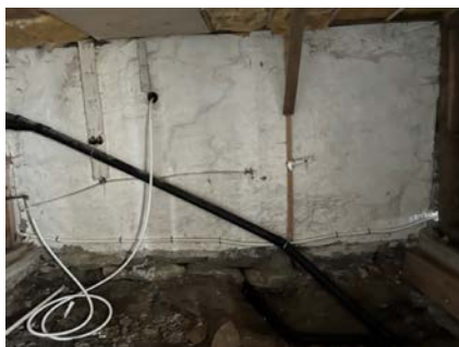
Fuktighet i kjeller.
