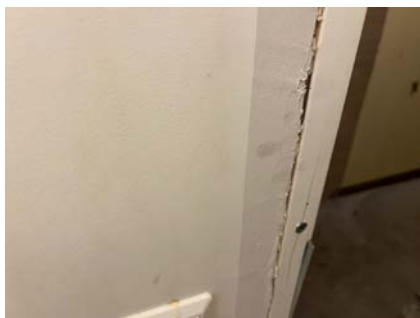
Skade på ytterdør til leilighet.
