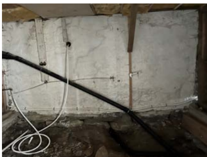
Sprekker i grunnmur.
