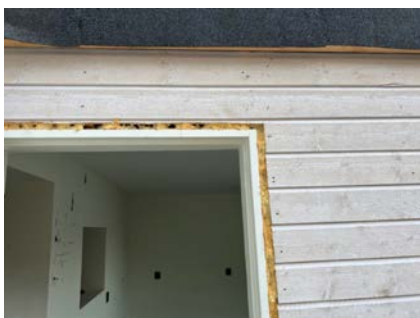
Det mangler lister til ytterdør tilbygg.
