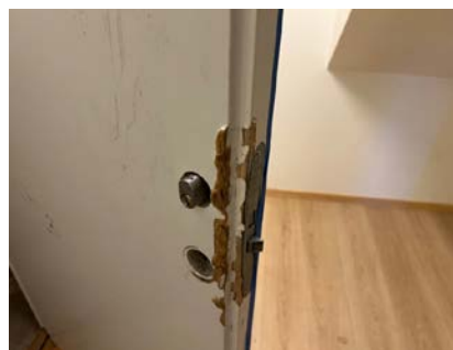
Skade på dør til leilighet.
