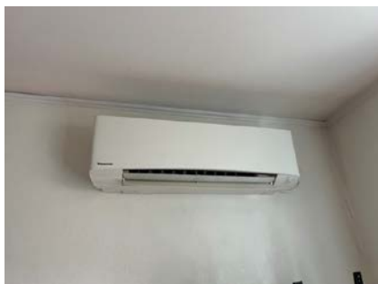
Varmepumpe i stue 1. etasje leilighet vest.
