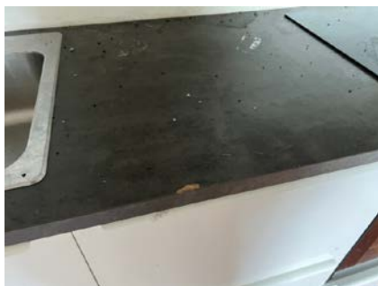
Skde på benkeplater.
