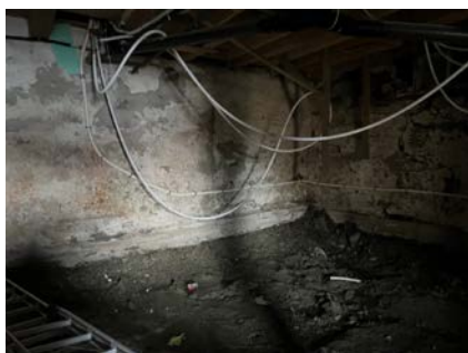
Delvis utgravd kjeller. Fuktighet i kjeller.
