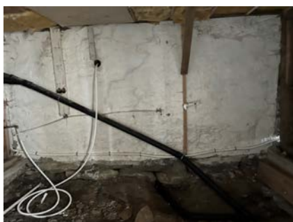
Fuktighet i kjeller.
