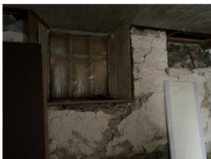
Sprekker i grunnmur.
