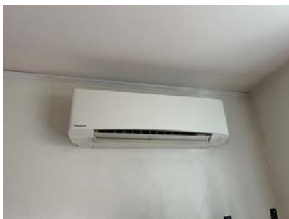
Varmepumpe i stue 1. etasje leilighet vest.
