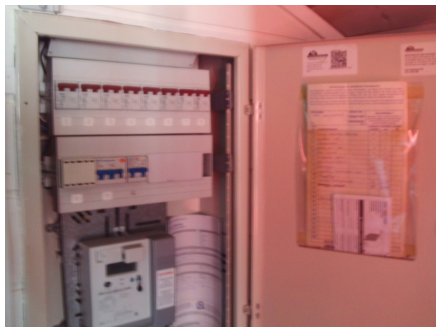
Sikringsskapet er plassert i vindfang
