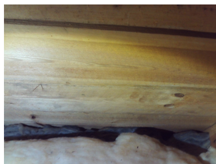
Lite/ingen lufting i mellom isolasjon og undertak.
