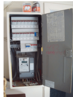
Sikringsskapet er plassert på loftet og er blitt oppgradert med automatsikringer
