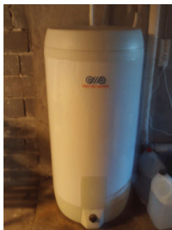
Bereder er plassert i grovkjeller.
