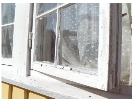
Slitasje på utvendig karm og ramme.
