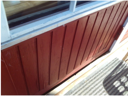
Noe slitt på utvendig brystning
