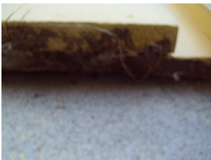
Lite/ingen lufting bak kledning ved grunnmur
