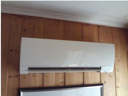
Varmepumpe i stue.
