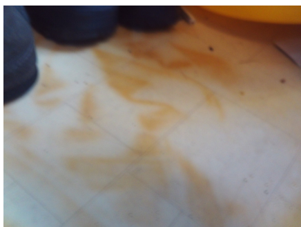
Noe misfarging på belegget.
