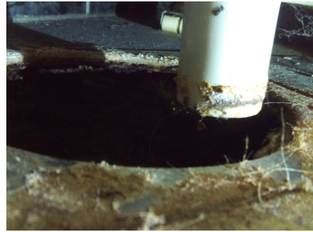
Sluk under dusjkabinett.
