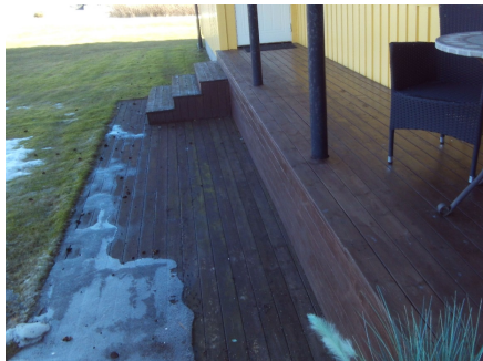
Skulle vært en sikring/rekkverk
