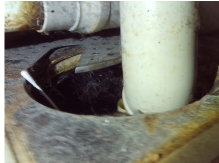
Sluk under dusjkabinett
