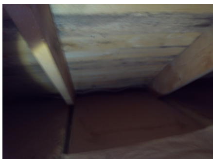
Noe blåved på undertaket enkelte steder.
