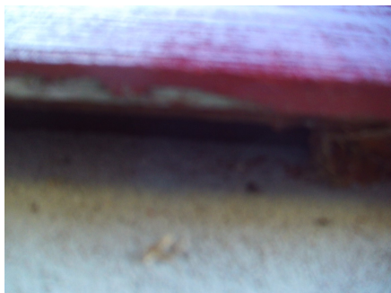
Noe lite tilgang på luft ved ringmur
