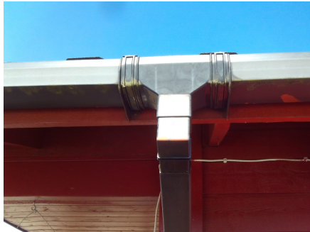
Eldre plastrenner i fra byggeåret.
