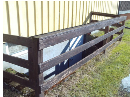
Lav høy og store åpninger i rekkverk.
