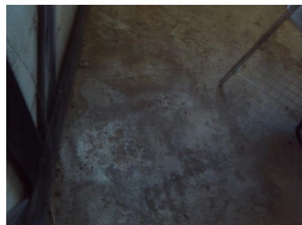
Saltutslag på støpte gulv
