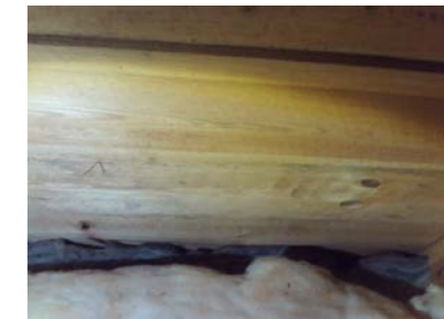
Lite/ingen lufting i mellom isolasjon og undertak.
