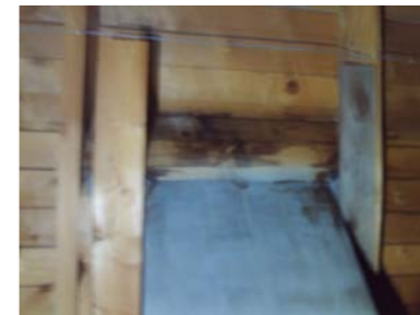
Eldre fuktmerker i rundt pipe. (Er nå helbeslått over tak)
