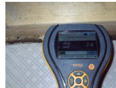
Fuktmåling i åpen vegg i mot bod
