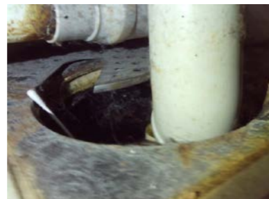
Sluk under dusjkabinett
