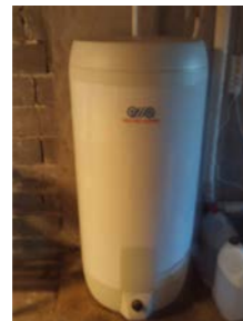
Bereder er plassert i grovkjeller.
