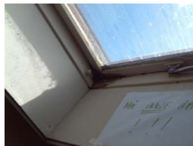
Et eldre slitt/skadet takvindu.
