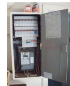
Sikringsskapet er plassert på loftet og er blitt oppgradert med automatsikringer
