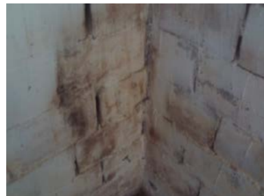
Fuktvandring og eldre fuktmerker
