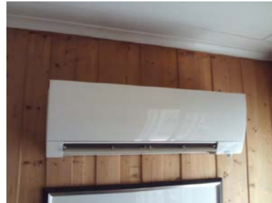
Varmepumpe i stue.
