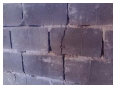
En sprekke i grunnmur innvendig i grovkjeller ble registrert.
