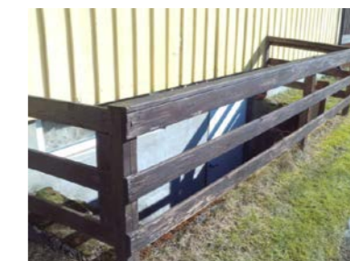
Lav høy og store åpninger i rekkverk.
