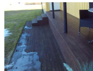
Skulle vært en sikring/rekkverk
