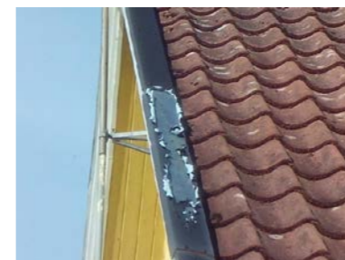
Folie har løsnet på vannbord som er beslått.
