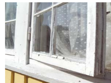
Slitasje på utvendig karm og ramme.
