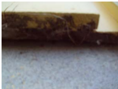
Lite/ingen lufting bak kledning ved grunnmur
