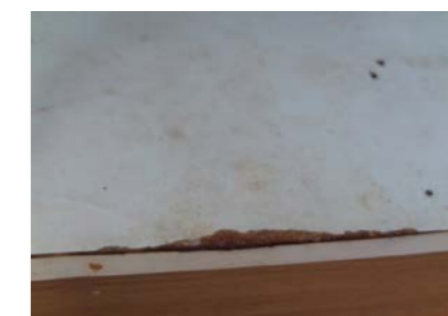
Bunnplate har svellet noe under vasken.
