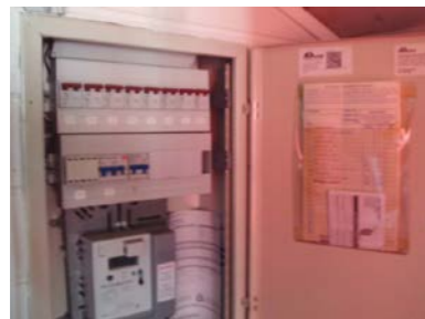
Sikringsskapet er plassert i vindfang
