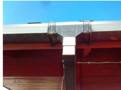
Eldre plastrenner i fra byggeåret.
