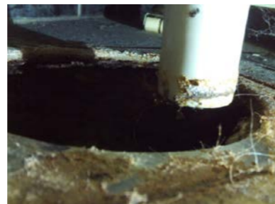
Sluk under dusjkabinett.
