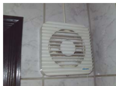
Vifte i ytterveggen.
