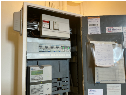
Automatsikringer i sikringsskap plassert i gang/fellesareal.
