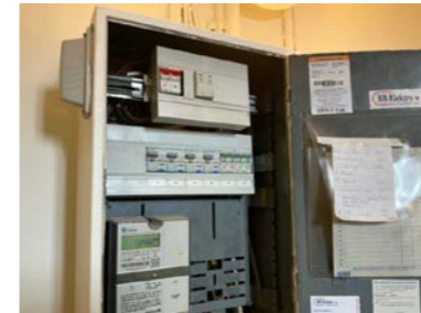
Automatsikringer i sikringsskap plassert i gang/fellesareal.
