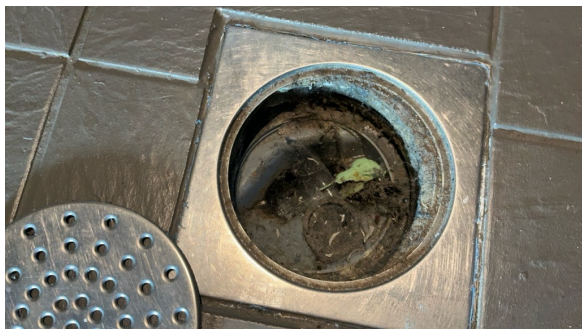
Sluk på i nærheten av vask
