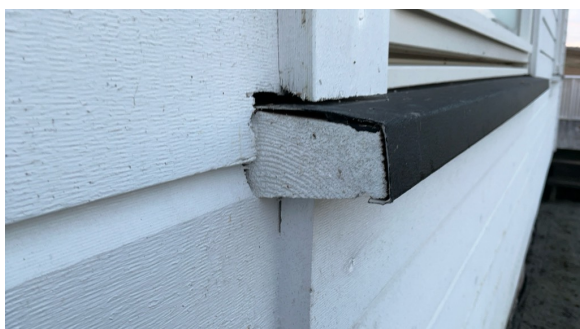
Feil vinkel på vannbrett
