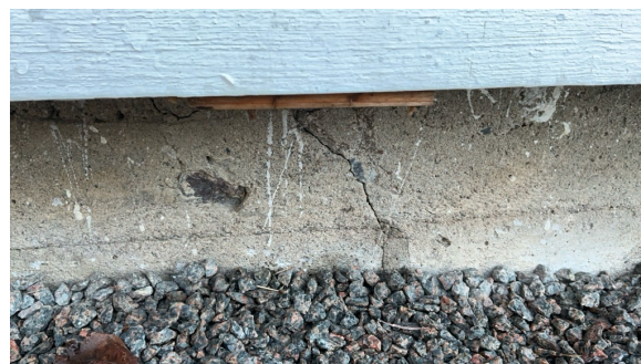
Sprekk i betongmur
