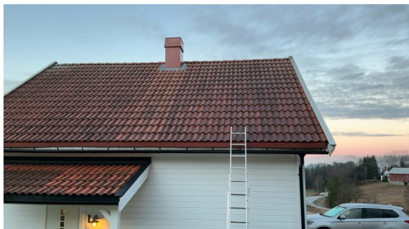
Mangler snøfangere samt st
