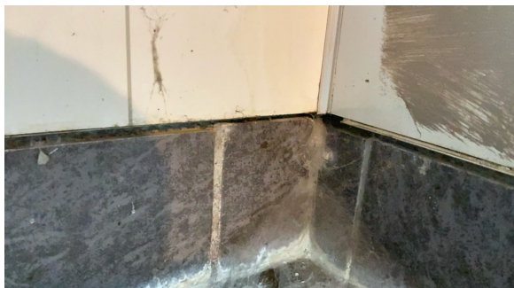
Manglende tetting mellom baderomspanel og sokkelflis
