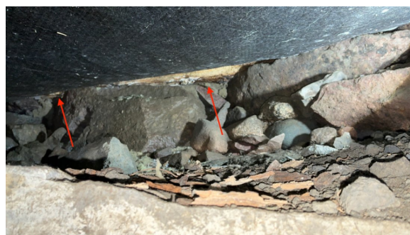
Råte i bunnsvill
