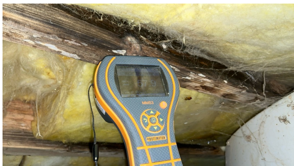
Høy fuktighet og råte i bjelke
