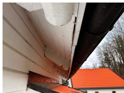
Skjevhet i takkonstruksjon ute ved renne
