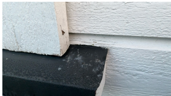
Ingen klaring mellom beslag og kledning/listverk
