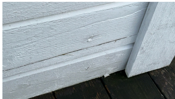
Sprekk i kledning, og kledning med lite avstand til terrasse
