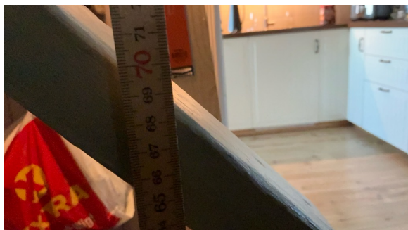
For lavt rekkverk
