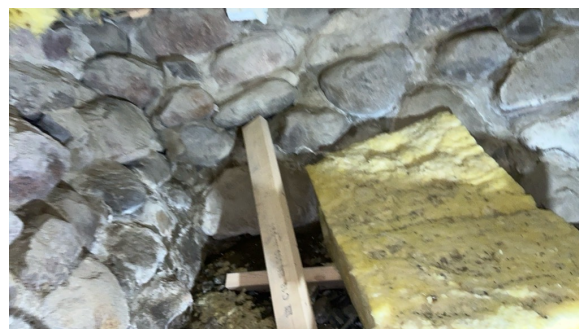
Isolasjon har falt ned
