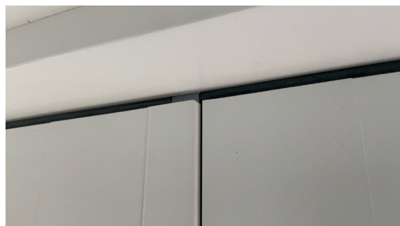
Liten utetthet/åpning mellom dørbladene i toppen.
