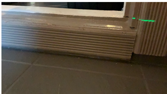
Membran ikke synlig ved dørterskel
