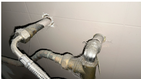
Ikke tette rørgjennomføringer bak dusjkabinett
