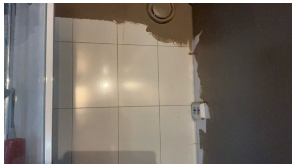
Manglende maling på baderomsplater bak dusjkabinett
