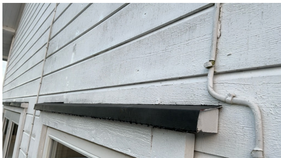
Ingen klaring mellom beslag og kledning
