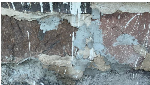
Enkelte sprekker i gråsteinsmur.
