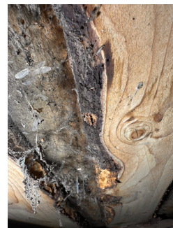
Spor av treborende insekter i takkonstruksjon
