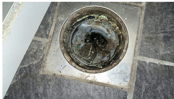
Sluk under dusjkabinett
