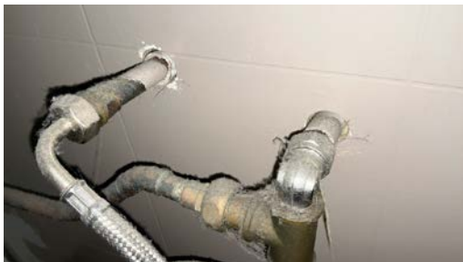
Ikke tette rørgjennomføringer bak dusjkabinett
