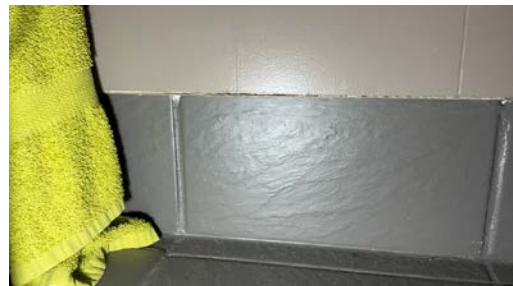
Manglende silikon mellom baderomspanel og bunnlist
