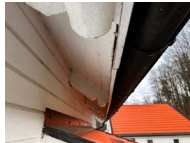
Skjevhet i takkonstruksjon ute ved renne
