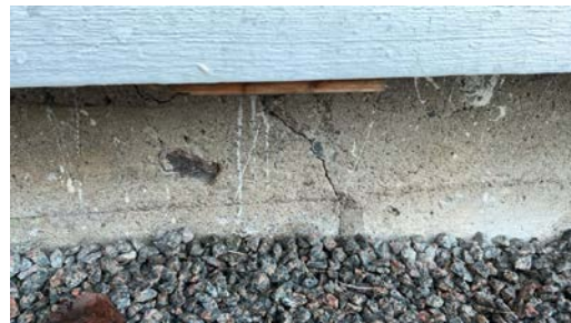
Sprekk i betongmur
