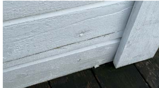
Sprekk i kledning, og kledning med lite avstand til terrasse
