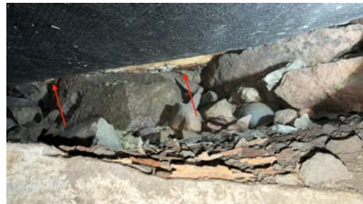
Råte i bunnsvill
