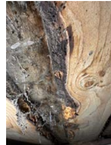
Spor av treborende insekter i takkonstruksjon
