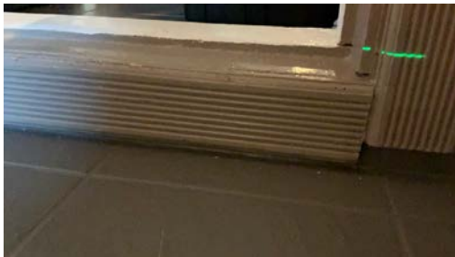
Membran ikke synlig ved dørterskel
