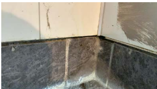
Manglende tetting mellom baderomspanel og sokkelflis
