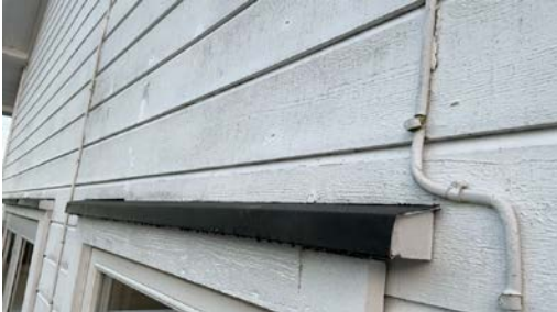
Ingen klaring mellom beslag og kledning
