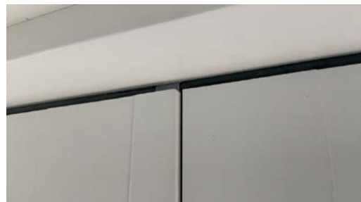
Liten utetthet/åpning mellom dørbladene i toppen.
