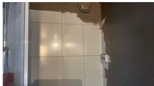
Manglende maling på baderomsplater bak dusjkabinett
