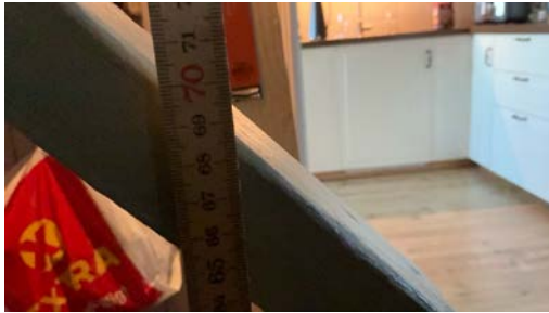
For lavt rekkverk
