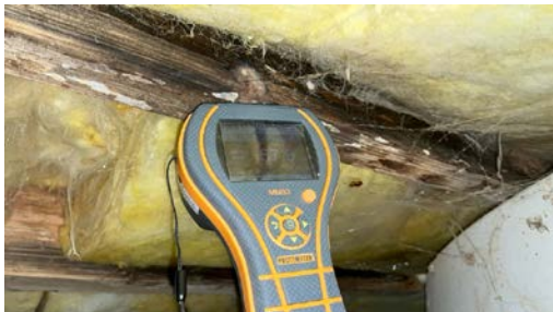
Høy fuktighet og råte i bjelke
