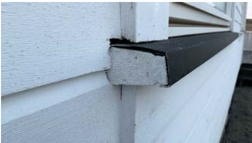
Feil vinkel på vannbrett
