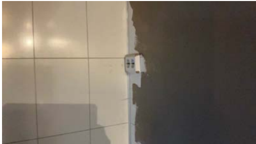
Stikk kontakt i dusjsonen.
