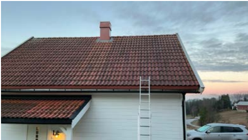
Mangler snøfangere samt st
