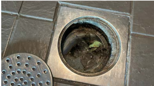
Sluk på i nærheten av vask
