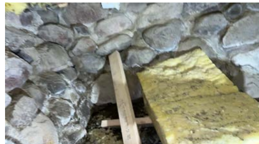
Isolasjon har falt ned
