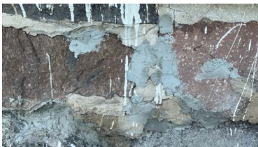
Enkelte sprekker i gråsteinsmur.
