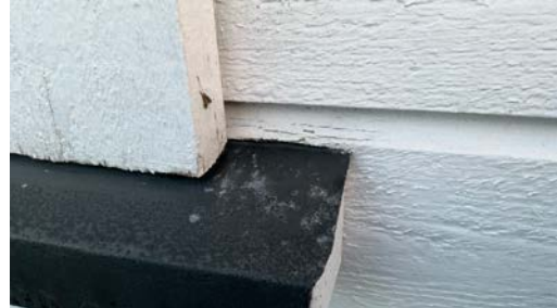
Ingen klaring mellom beslag og kledning/listverk
