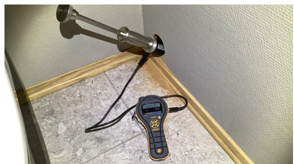
Fuktmåling ble foretatt, jeg målte skadelig fukt.
