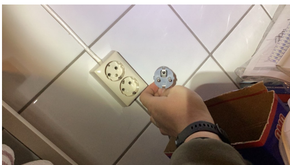
Sjekk av støpsel på bereder i tilbygd del.
