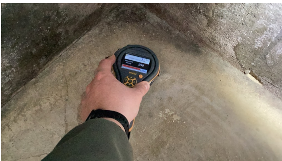
Påvist forhøyede fuktindikasjoner i overflater på betonggulv som er mer eller mindre vanlig på eldre gulv uten fuksperre og samtidig kan ha en sammenheng med sviktende fuksikring.
