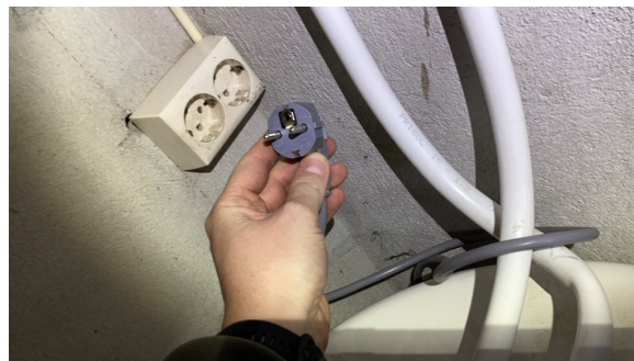
Sjekk av støpsel på bereder i opprinnelig del.
