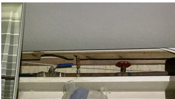
Stoppekran i garderobe på tilbygd del.
