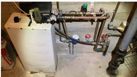
Vannmåler og stoppekran i kjeller på opprinnelig del.
