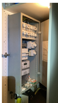
Sikringskap i garderobe i tilbygd del.
