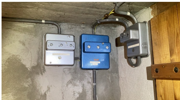
Inntak i kjeller på hoveddel.
