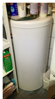
Varmtvannstank fra 1994 på bad i kjeller på tilbygd del.
