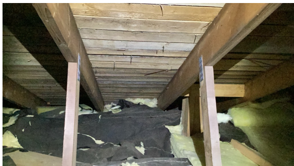
Spiker gjennom undertak enkelte steder.
