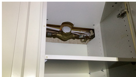
Vannmåler i garderobe på tilbygd del.
