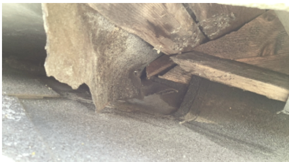
Ved snø, snøsmelting og hard vær kan det trenge vann inn bak shingelen i overgang tekking og ark.
