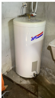
Varmtvannstank i kjeller på opprinnelig del fra 1994.
