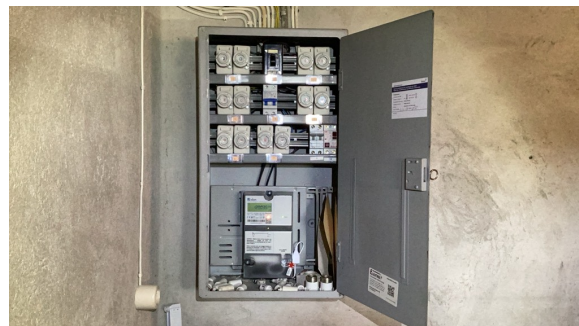
Sikringskap i oprinnelig del.
