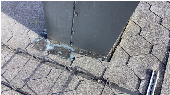
Shingel ikke lagt som anbefalt ved beslag.
