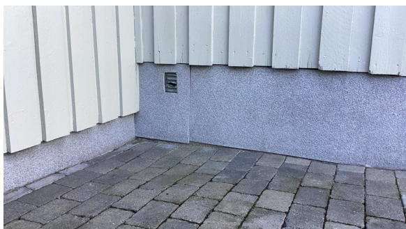
Noe skjevheter i fasadeplater.
