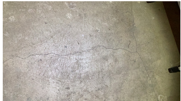
Riss og sprekker i gulv,
