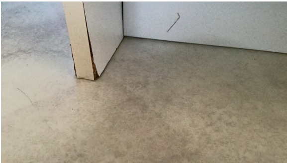
Svelling på innredning.
