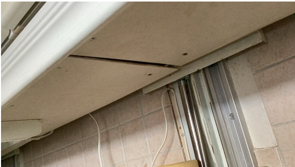
Løs bunnplate på overskap.
