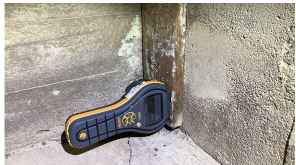
Fuktmåling ble foretatt, jeg målte skadelig fukt.
