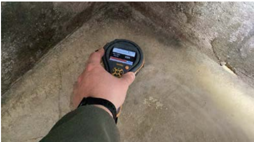
Påvist forhøyede fuktindikasjoner i overflater på betonggulv som er mer eller mindre vanlig på eldre gulv uten fuktsperre og samtidig kan ha en sammenheng med sviktende fuktsikring.
