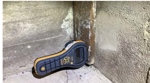
Fuktmåling ble foretatt, jeg målte skadelig fukt.
