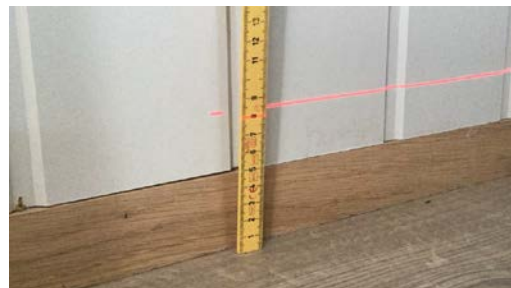
Helningsavvik ble målt til 40 mm i stue i tilbygd del.
