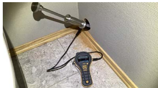
Fuktmåling ble foretatt, jeg målte skadelig fukt.
