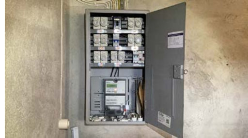
Sikringsskap i oprinnelig del.
