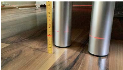
Helningsavvik på 17 mm ble målt innenfor 2 meter på soverom.
