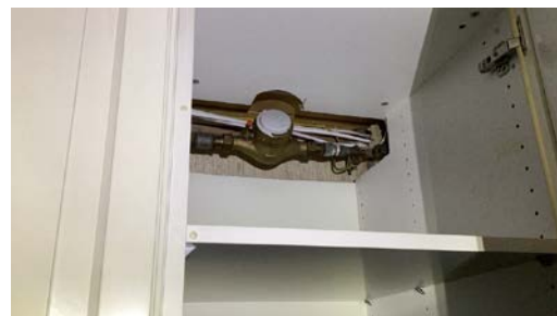
Vannmåler i garderobe på tilbygd del.
