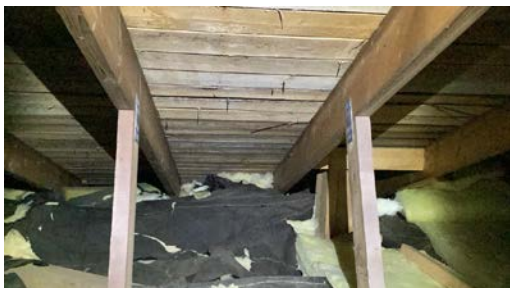
Spiker gjennom undertak enkelte steder.
