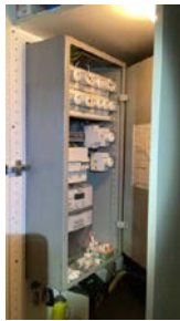
Sikringsskap i garderobe i tilbygd del.
