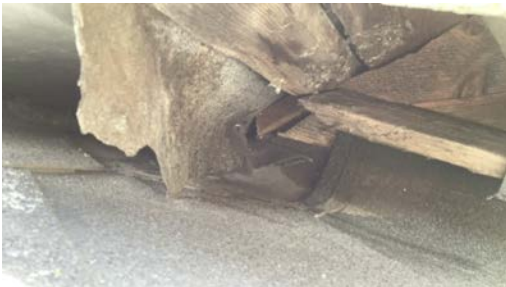
Ved snø, snøsmelting og hard vær kan det trenge vann inn bak shingelen i overgang tekking og ark.
