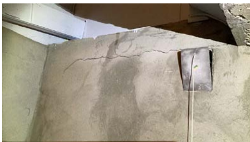
Sprekk i mur.
