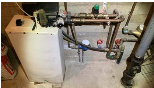
Vannmåler og stoppkran i kjeller på opprinnelig del.
