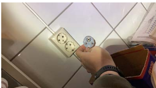
Sjekk av støpsele på bereder i tilbygd del.
