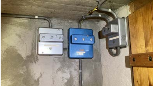
Inntak i kjeller på hoveddel.
