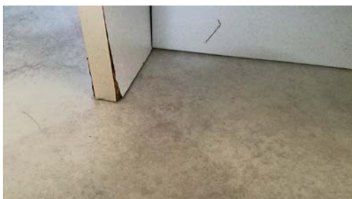
Svelling på innredning.
