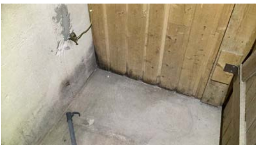
Misfarging på treverk.
