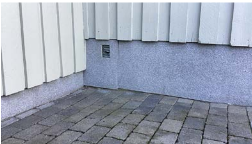
Noe skjevheter i fasadeplater.
