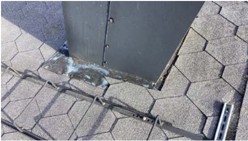
Shingel ikke lagt som anbefalt ved beslag.
