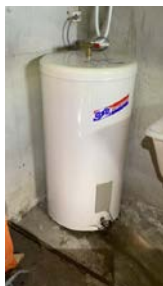
Varmtvannstank i kjeller på opprinnelig del fra 1994.
