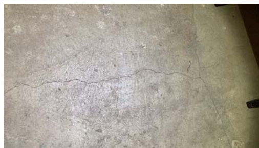
Riss og sprekker i gulv,
