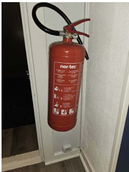
Brannslukningsapparat montert ved entré/stue.
