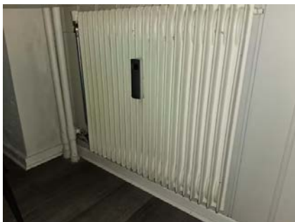
Leiligheten er i hovedsak oppvarmet med radiatorer.
