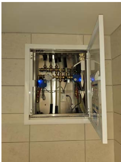
Vannfordelerskap med stoppekraner er plassert på bad.
