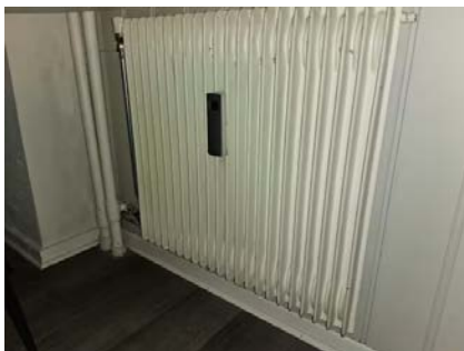
Leiligheten er i hovedsak oppvarmet med radiatorer.
