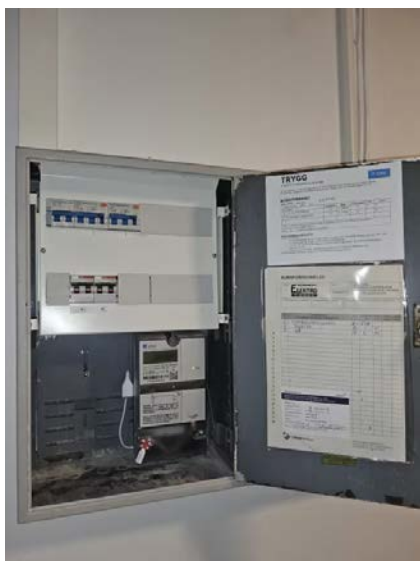
Sikringsskap er plassert i felles gang.
