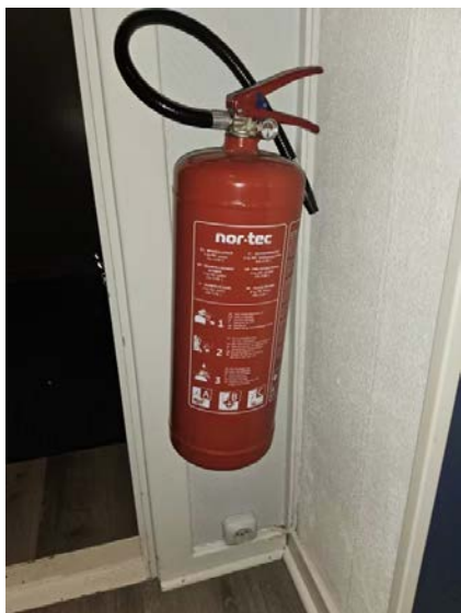
Brannslukningsapparat montert ved entré/stue.
