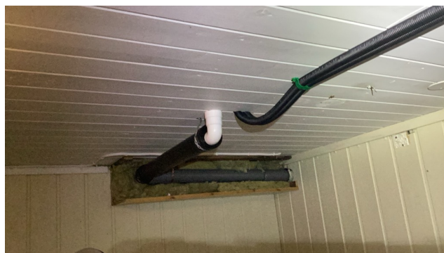
Rør til kjøkken
