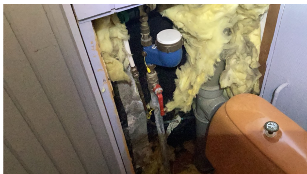
Galvanisert vannrør i inntak.
