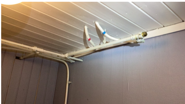
Kobbervannrør fra byggeåret
