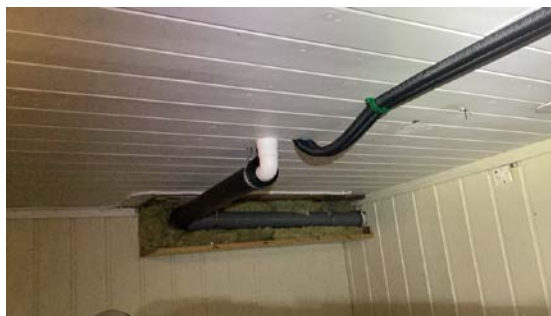
Rør til kjøkken
