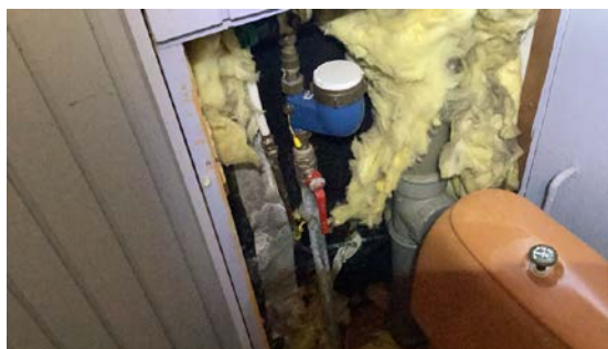
Galvanisert vannrør i inntak.
