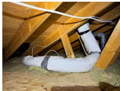
Nytt ventilasjonsrør fra bad
