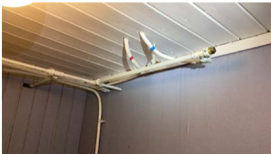
Kobbervannrør fra byggeåret
