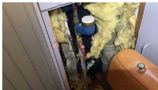
Galvanisert vannrør i inntak.
