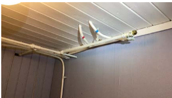
Kobbervannrør fra byggeåret
