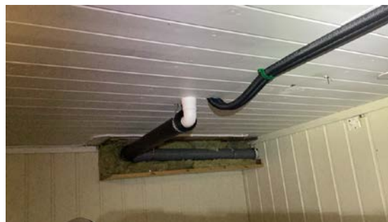
Rør til kjøkken
