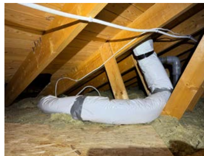
Nytt ventilasjonsrør fra bad
