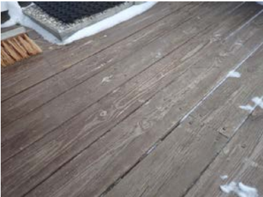
Noe slitasje og spikerhoder på vei opp.
