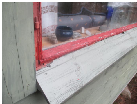
Vannbord ikke riktig montert.
