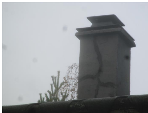
Sprekker i pipe over tak som er fuget igjen.
