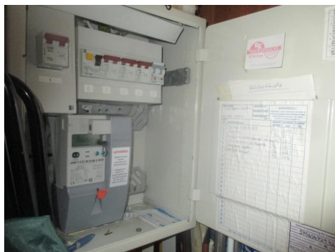
Sikringsskapet er plassert i gangen.
