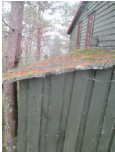
Utvendig bod med større skader.
