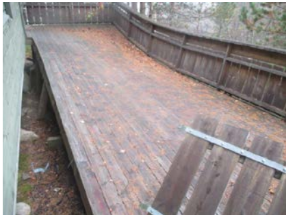
Deler av terrassen etter skade.
