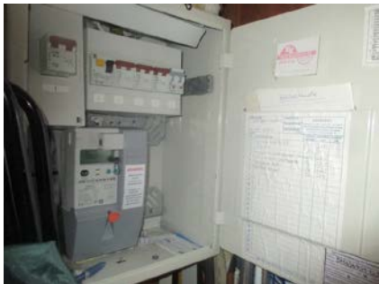
Sikringsskapet er plassert i gangen.
