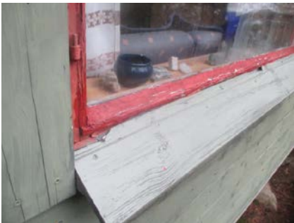
Vannbord ikke riktig montert.
