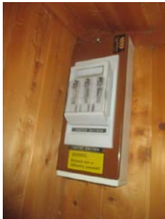
Hovedinntaket på ene soverommet.
