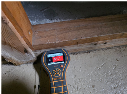
Swill under boddør mot N/
