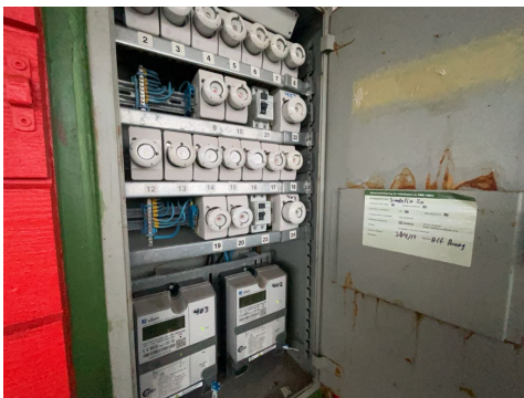
Original innmat i sikringsskap.
