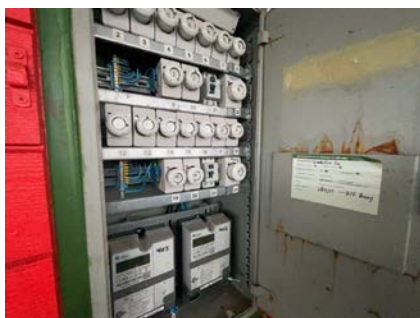
Original inmat i sikringskap.
