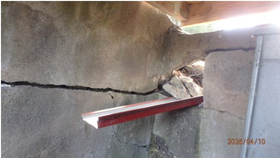
Flere sprekker i mur
