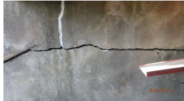
Flere sprekker i mur
