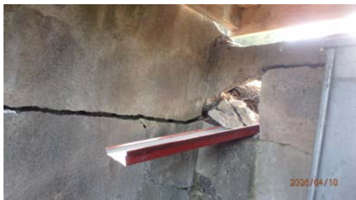
Flere sprekker i mur
