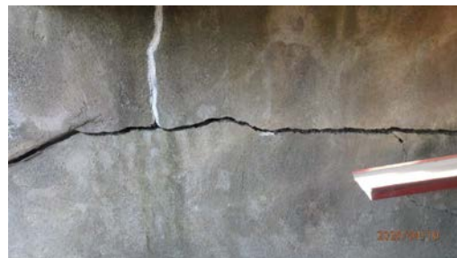
Flere sprekker i mur
