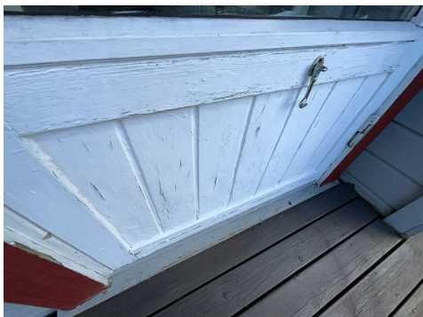
Værslitasje i utvendig overflate på terrassedør.
