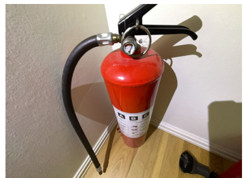
Slukkingsapparat eldre enn 10 år.
