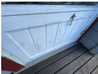
Værslitasje i utvendig overflate på terrassedør.
