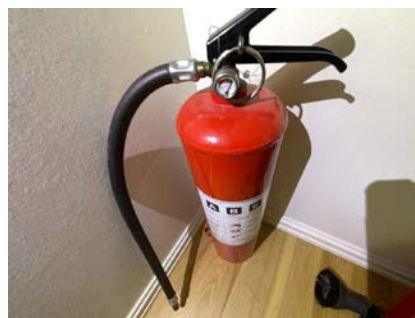
Slukningsapparat eldre enn 10 år.
