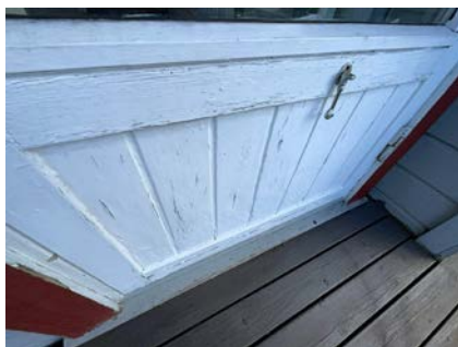
Værslitasje i utvendig overflate på terrassedør.
