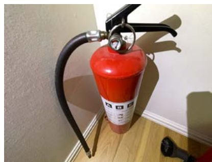
Slukningsapparat eldre enn 10 år.
