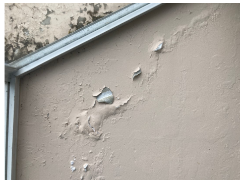
Saltutslag i vegg altan
