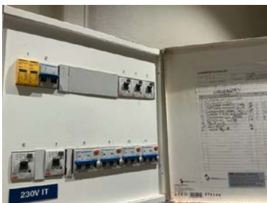
Automatsikringer i sikringsskap plassert i entré.
