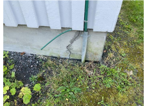
Sprekker i grunnmur.
