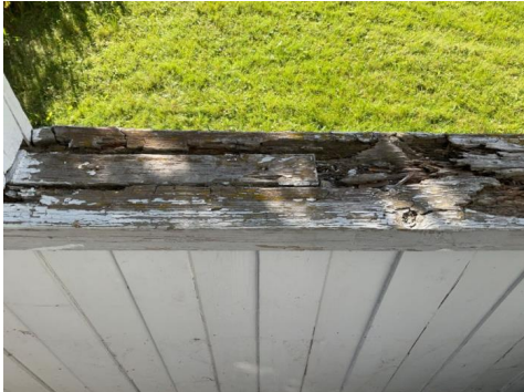
Råte i topprekke på veranda i 1. etasje.
