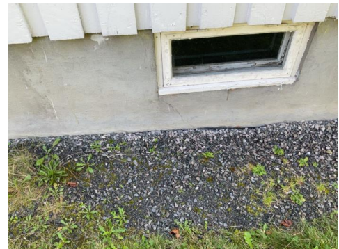
Riss i grunnmur.
