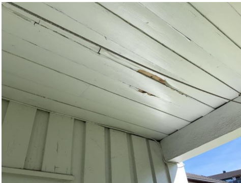
Maling flasser på grunn av utett blikk i 2. etasje.
