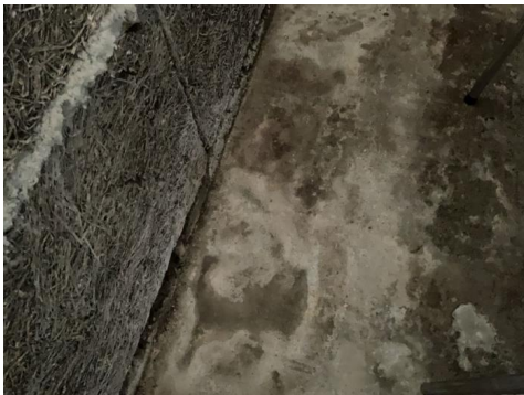
Fukt i gulv og vegg i kjeller.
