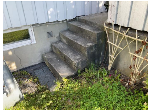
Manglende rekkverk på trapp til veranda i 1. etasje.
