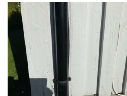
Nedløpsrør med frostsprenning.
