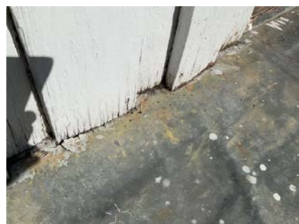
Sprekker og begynnende råter i kledning med mot gulv på veranda i 2. etasje.
