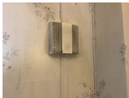
Vifte på veggen.
