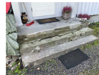
Slitt trapp ved inngangsparti.
