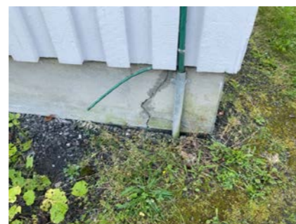
Sprekker i grunnmur.
