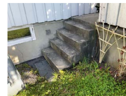
Manglende rekkverk på trapp til veranda i 1. etasje.
