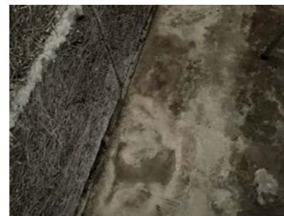
Fukt i gulv og vegg i kjeller.
