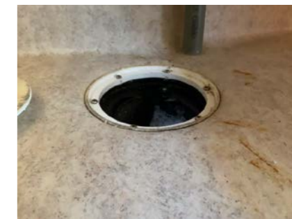
Det mangler vanntett oppkant på avløp fra vask. Dette er kun tettet med Silicon.
