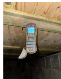
Fuktverdi målt i etasjeskille/bjelkelag til 24,2 vektprosent.
