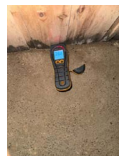
Fuktskader i panel på innforede vegger.
