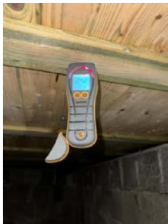
Fuktverdi målt i etasjeskille/bjelkelag til 24,2 vektprosent.
