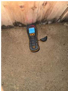
Fuktskader i panel på innforede vegger.
