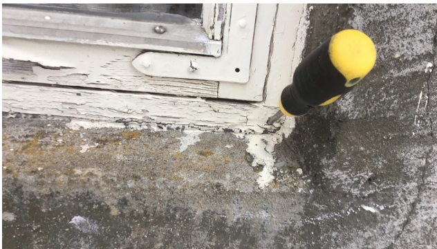
Fukt skader i nedkant mot mur
