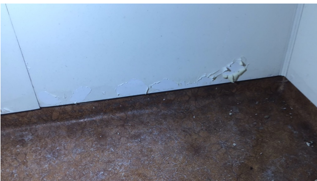
Fukt skader i nedkant våtromsplater i dusj
