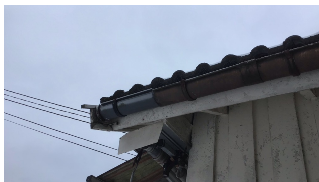
Utetheheter i takrenne
