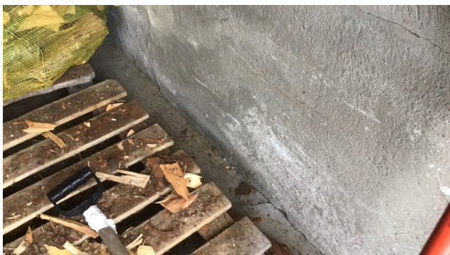
Fukt i mellom gulv og vegger
