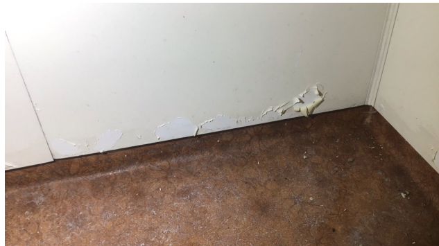
Fuktskader i nedkant våtromsplater i dusj
