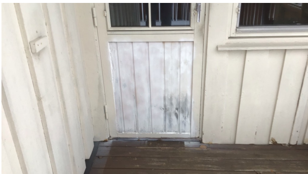
Skader i dør speil
