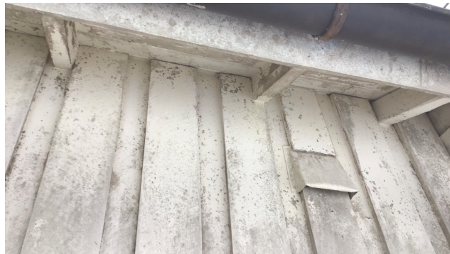
Mangler luftespalte i gesims
