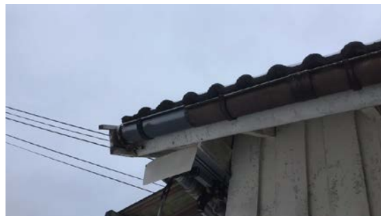
Utettheter i takrenne
