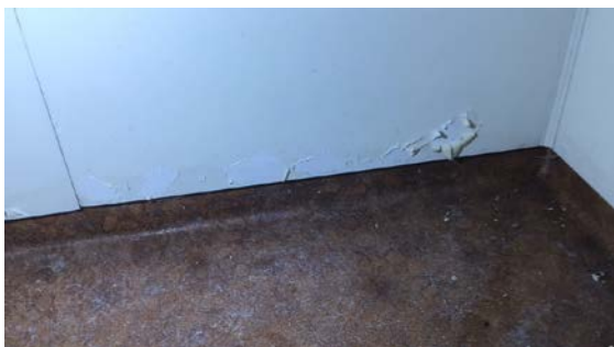
Fukt skader i nedkant våtromsplater i dusj
