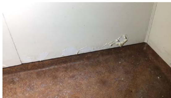
Fuktskader i nedkant våtromsplater i dusj
