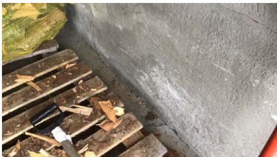
Fukt i mellom gulv og vegger
