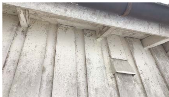
Mangler luftespalte i gesims
