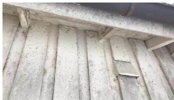
Mangler luftespalte i gesims
