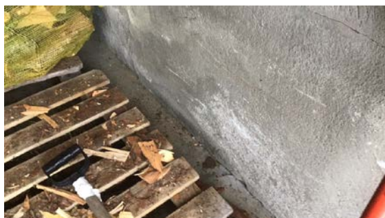
Fukt i mellom gulv og vegger
