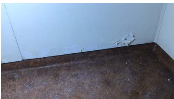
Fukt skader i nedkant våtromsplater i dusj
