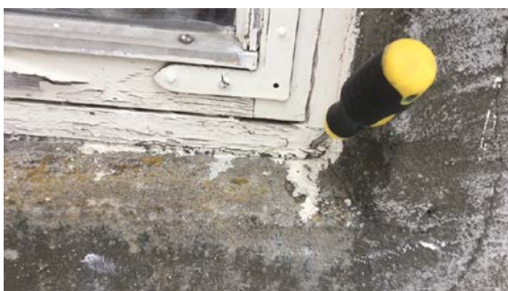
Fukt skader i nedkant mot mur
