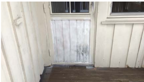
Skader i dør speil
