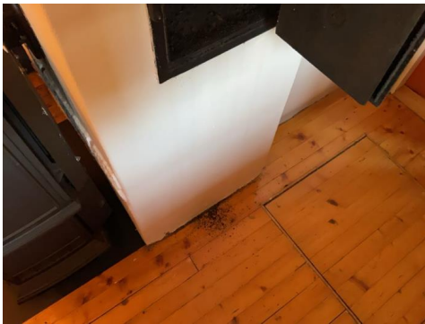
Manglende plate på gulv ved sotleuke
