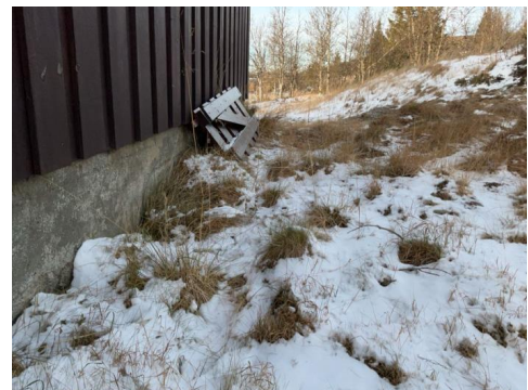
Terrengfall mot bygning
