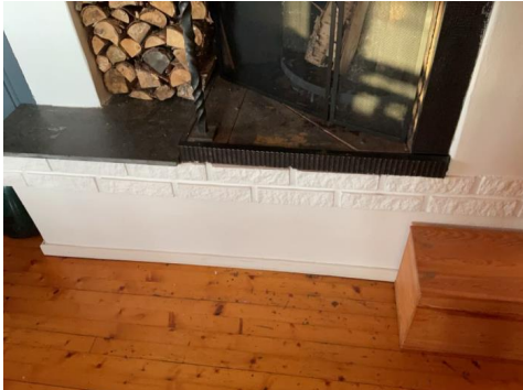
Manglende plate på gulv foran peis
