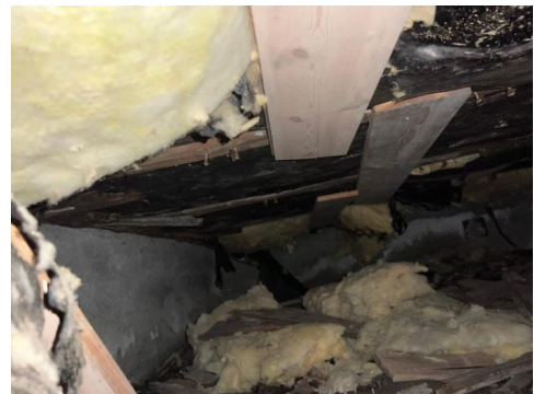
Avvik i kryprom/gulvkonstruksjon
