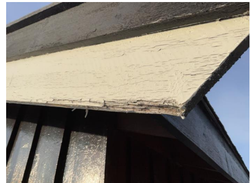
Råte i vindskieende
