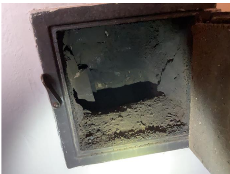
Røykrør og sotleuke er plassert i lik høyde, høyde røykrør fra ovn bør endres
