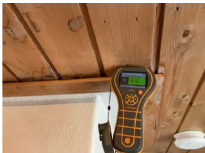
Fuktskjolder stedvis i himling og rundt pipestamme, ved fuktmåletaking var det ikke fuktutslag
