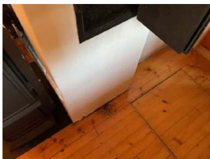
Manglende plate på gulv ved sotluke
