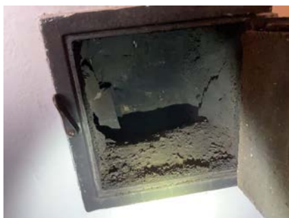
Røykrør og sotluke er plassert i lik høyde, høyde røykrør fra oven bør endres
