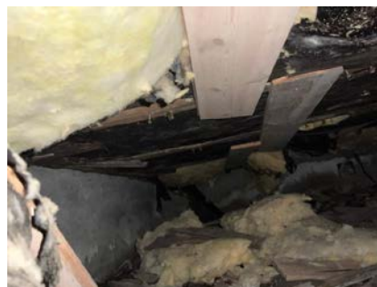
Avvik i kryprom/gulvkonstruksjon
