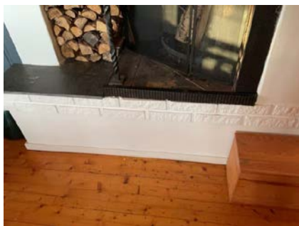
Manglende plate på gulv foran peis
