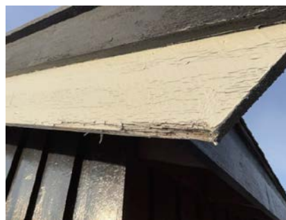
Råte i vindskieende
