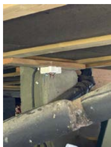
Åpen koblingsboks under hytten med løse ledninger.
