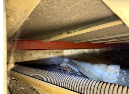
Sprekk i grunnmur
