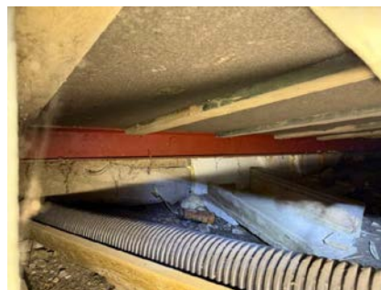
Sprekk i grunnmur
