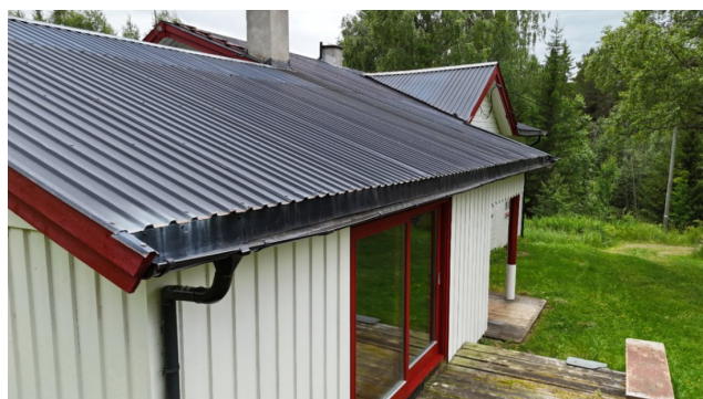
Nedbøyninger i takrenner pga snøpress.
