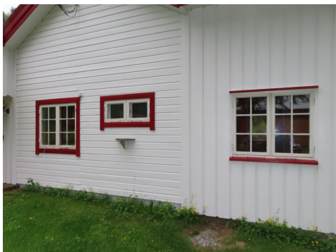
Vinduer på inngangssiden. Eldre, enklere vinduer.
