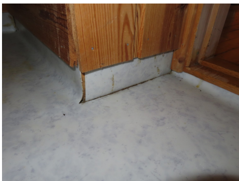
Utett gulv på vaskerom.
