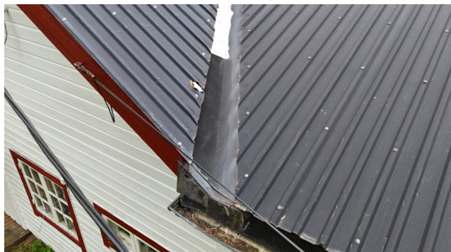
Skader i plateender inn mot kilrenne pga snø- og ispress.
