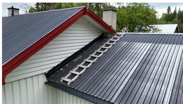
Trestige montert - dette holder ikke mål - fuktskader.
