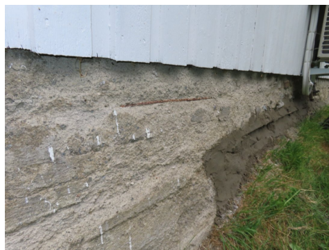
Avskalling i muren pga fuktopptrekk og frost. Er under reparasjon.
