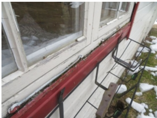
Vindu Utetthet mellom utv. omrammingslist og vinduskarm - merk fuktinntrekk og fare for fuktskade i vegg.
