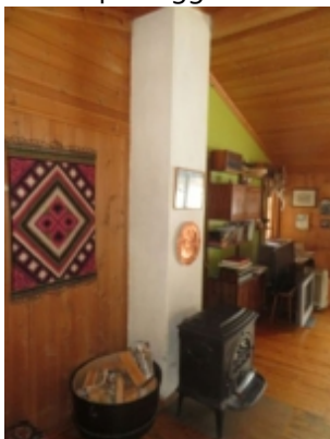
Peisovn stue Pipestokk med peisovn i stuen. Sotluke bak vedkjele, uten tiltak mot brennbart treverk både mot vegg og gulv.
