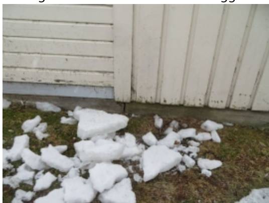
Ytterkledning. Det er påvist noe fuktopptrekk i kledningen som sjikter ned mot terreng = Vedlikeholdsbehov.
