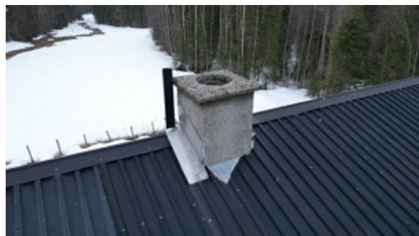
Pipe over tak opprinnelig del. Pipe over tak på opprinnelig del ses med ufullstendig takfotbeslag og utettheter ned mellom pipestokken og tekkingen.
