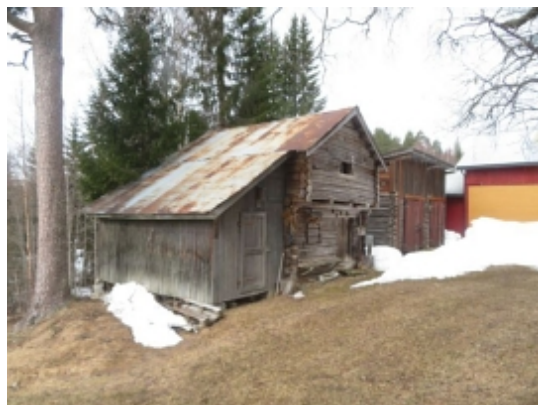
Stabbur Stabbur tilbygd med uisolert del. Merk rustdannelser i takplatene og naturlige vedlikeholdsbehov på bygget forøvrig.
