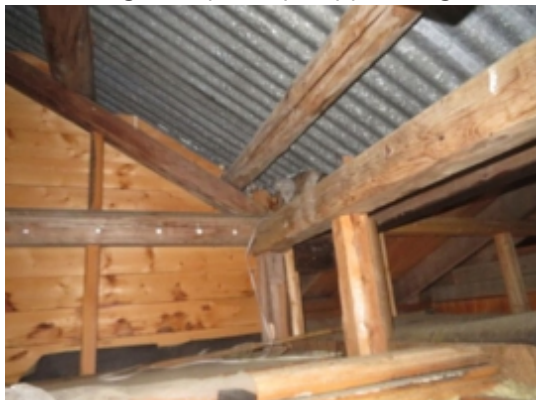
Kaldloft Del av kaldloft inspisert via luke i himling inne på kleve. Tekking uten undertak.
