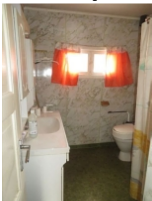
Bad. Baderom med sanitære installasjoner - dusj, toalett og servantskap.
