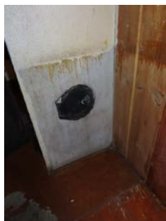
Sotluke på pipe på kjøkken. Sotluken sitter for nærme treverk samt at det mangler ubrennbar plate til gulv.
