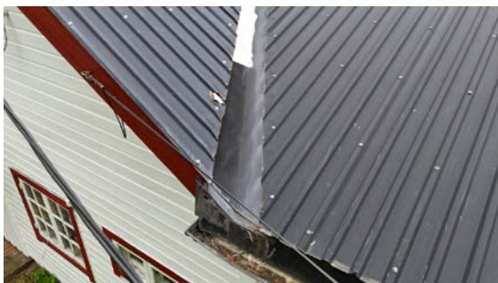
Skader i plateender inn mot kilrenne pga snø- og ispress.
