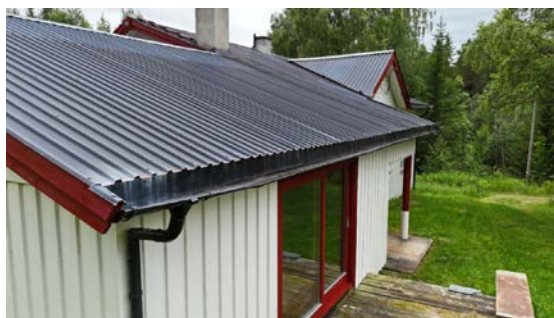
Nedbøyninger i takrenner pga snøpress.
