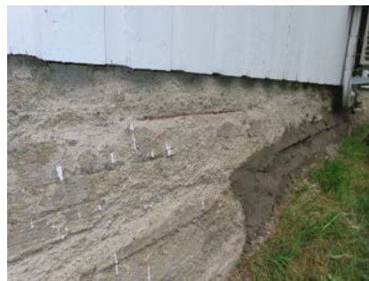
Avskalling i muren pga fuktopptrekk og frost. Er under reparasjon.
