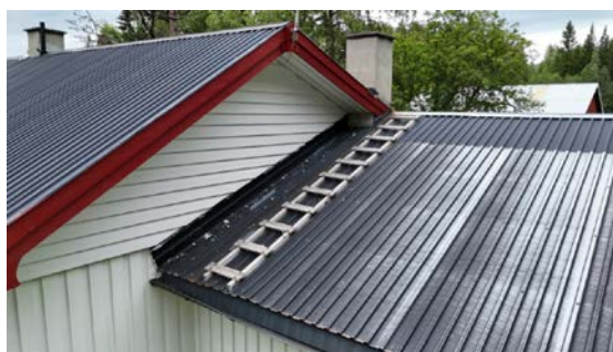
Trestige montert - dette holder ikke mål - fuktskader.
