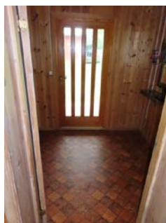
Hoveddør som noe enklere og definert som uisolert.
