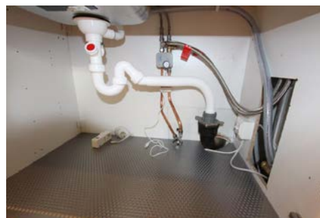
Røropplegg i kjøkkenbenk.
