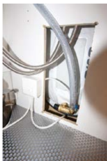
Varmtvannsbereder i hjørneskap på kjøkken.
