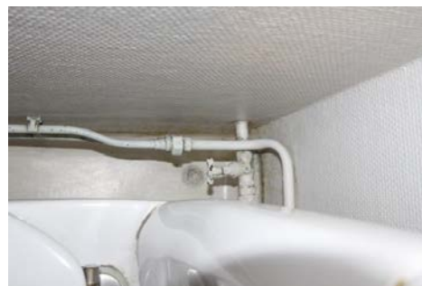
Stoppekran på bad/wc.
