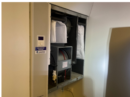
Aggregat står i vaskerom/bod.
