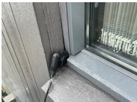
Fukt/råteskade på på stort vindu i stue TG 3
