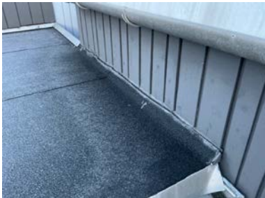
Glippe mellom trekking til car-port og vegg på bolig.
