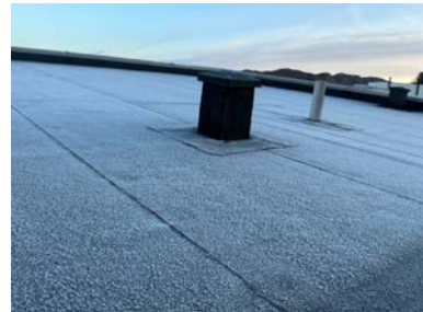
Noe rim på yttertak befaringsdagen.
