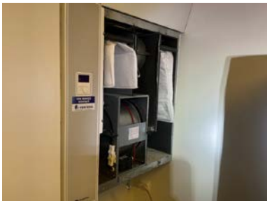
Aggregat står i vaskerom/bod.
