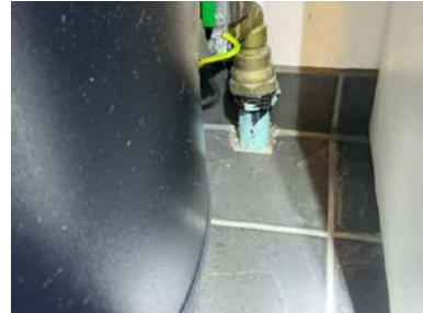
Synlig smøre-membran på vannrør
