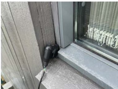
Fukt/råteskade på stort vindu i stue TG 3
